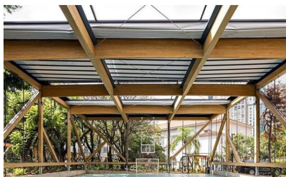
Figura 14: cobertura de quadra em São Paulo – SP – MLC da CROSSLAM. Fonte: site CROSSLAM
